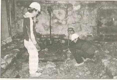
Les dalles en grès rose sont découpées par les tailleurs de pierre. Elles étaient recouvertes de béton avant l'incendie.
