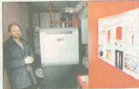
La chaufferie de la Croisée est l'un des sites de la route des énergies renouvelables. Photos Philippe Briquoleur
